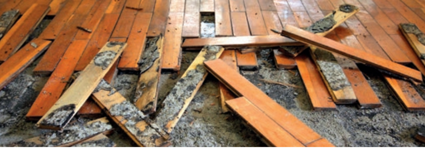
48 Schäden durch Stauwasser
