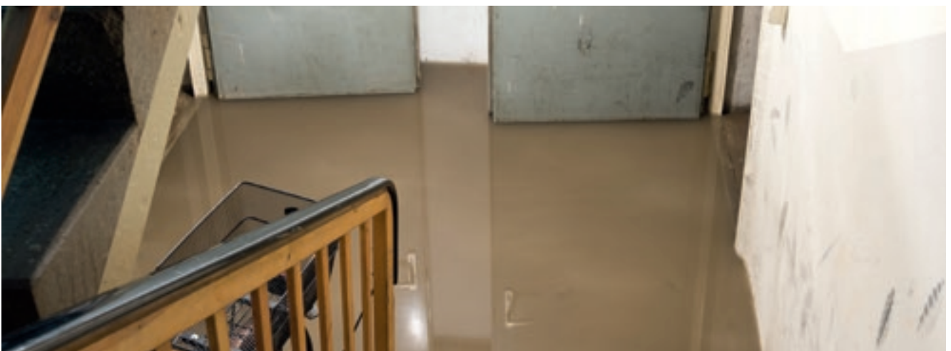
37 Kellerüberflutung nach Rückstau
